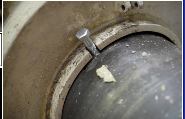
Verdrehsicherung mittels einfacher Sechskantschraube an einem Trockenzyylinder einer Papiermaschine.
