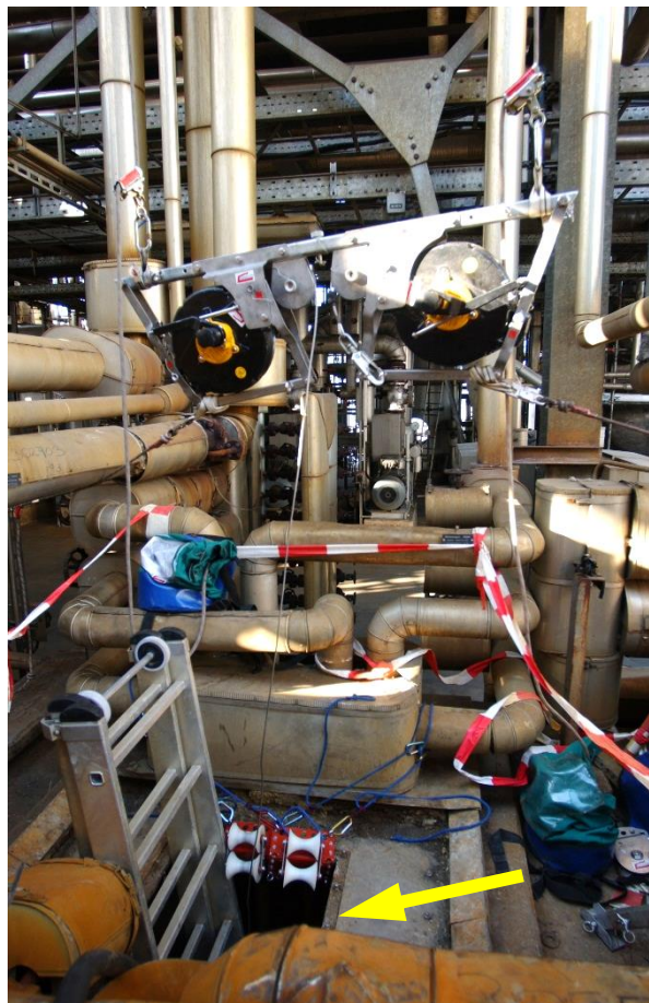
Fehlende Wehre an der Schachtöffnung.
