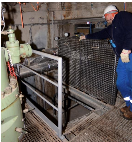
Der klappbare Gitterrost ist gegen Zufallen zu sichern; die — hier fehlende — Durchgangssperre verhindert einen Absturz von der Gehebene.
