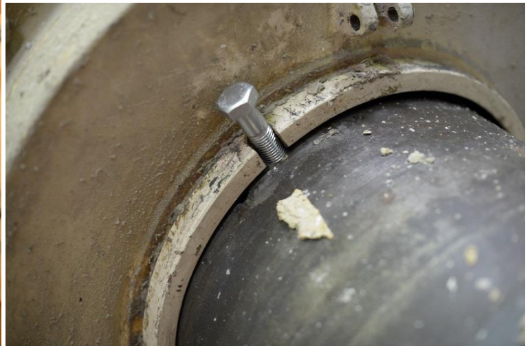
Verdrehsicherung mittels einfacher Sechskantschraube an einem Trockenzylinder einer Papiermaschine.
