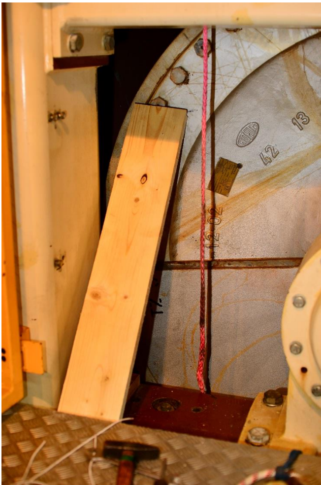
Improvisierte Verdrehsicherung an einem Trockenzylinder einer Papiermaschine mittels Kantholz (ohne Schließsystem-Sicherung).
