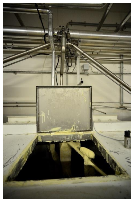
Der Einstiegsdeckel in den Tank muss gegen Zufallen gesichert sein! — Befindet er sich nicht höher als 1,0 (1,1 m) über der Gehebene, ist eine Umwehrung zusätzlich erforderlich!
